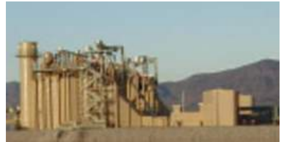
Figure 1. HRSG plant in western U.S.
